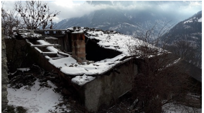
Westliches Hinterhaus mit eingebrochenem Dach
